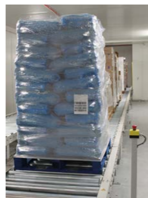
Een ondergrondse tunnel met transportband verbindt de al aanwezige gebouwen met het nieuwe magazijn.
